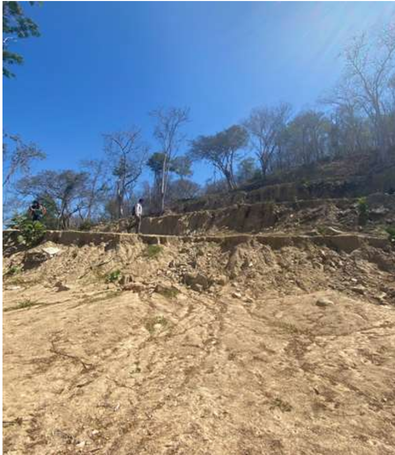
Fotografía 1. Lomerío, deslave y erosión
