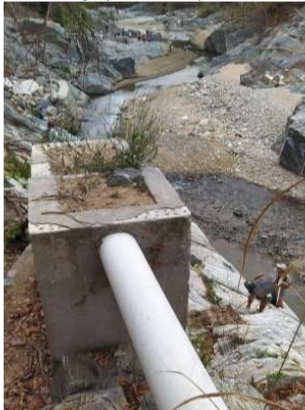
Fotografía 19. Línea de conducción de agua potable Cerro Espino-Erradura dañada por el huracán Agatha
