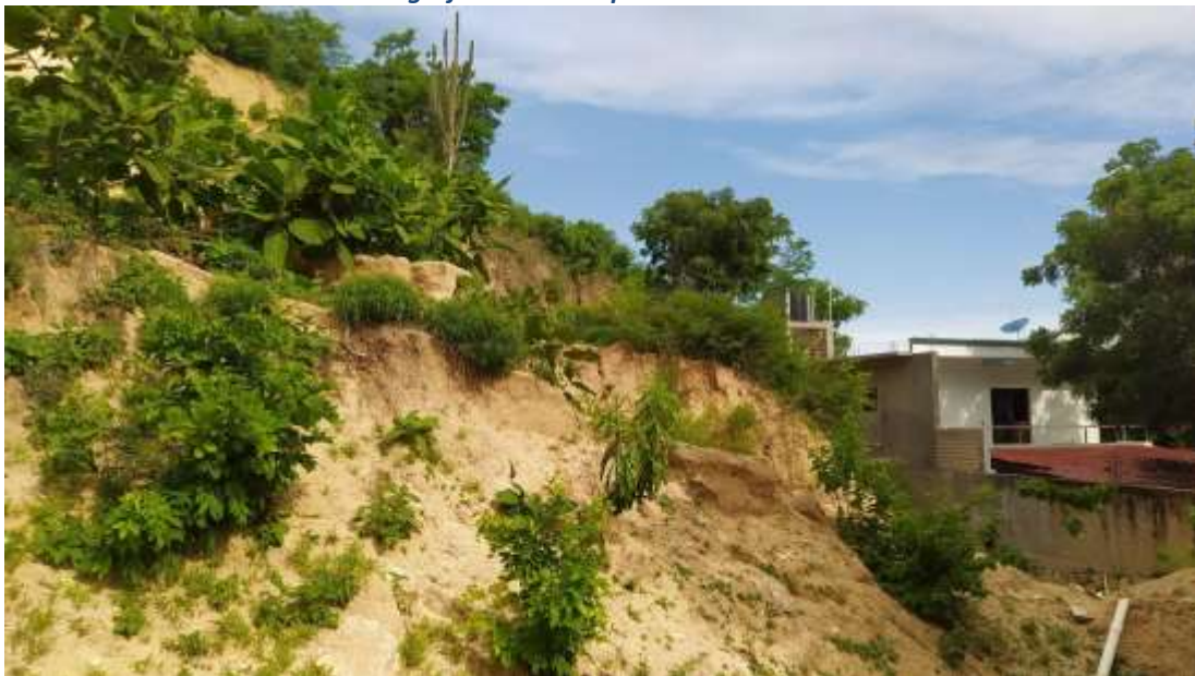
Fotografía 2. Erosión próxima a viviendas
