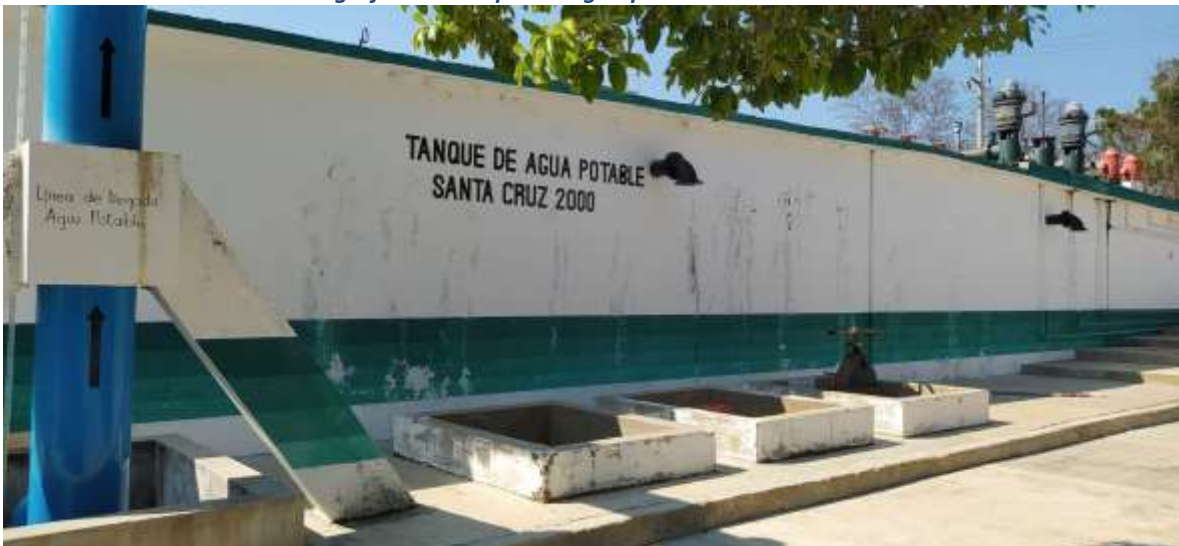
Fotografía 23. Tanque de agua potable Santa Cruz 2000
