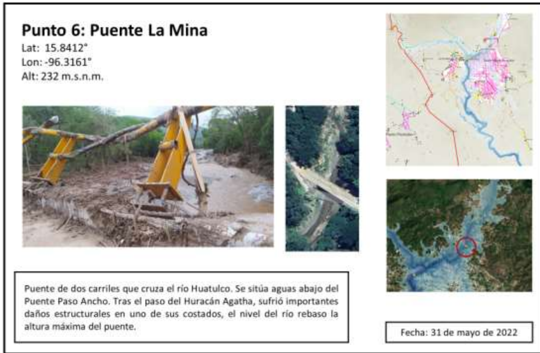
Figura 15. Descripción de zonas de afectación durante el Huracán Agatha (2022). Punto 6: Puente La Mina
