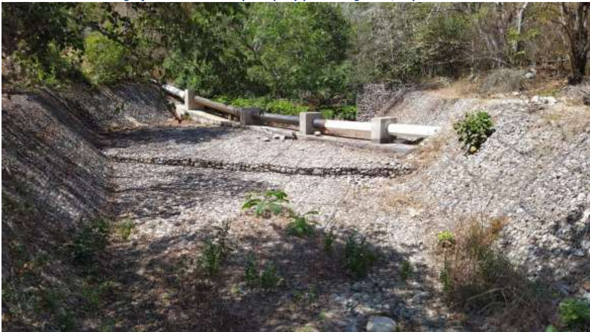
Fotografía 21. Acueducto principal y presa de gavión, Copalita Huatulco
