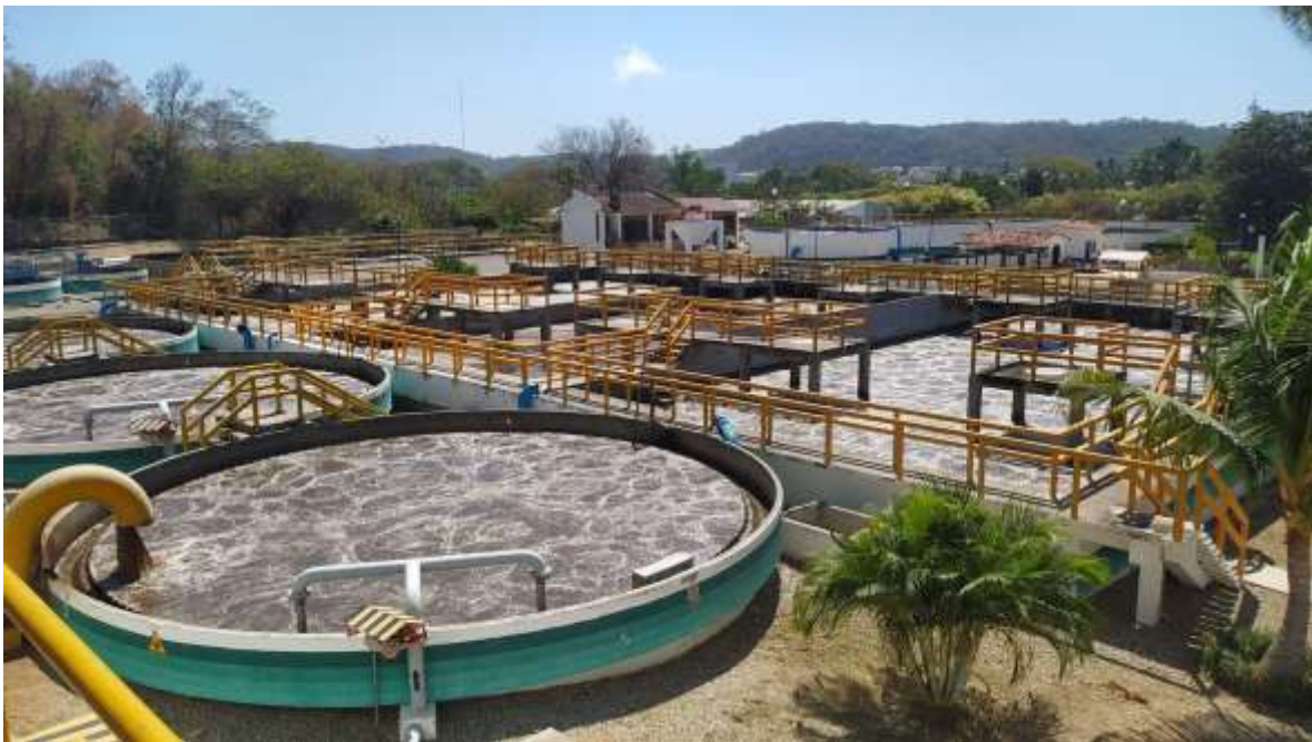
Fotografía 26. Planta de Tratamiento de Aguas Residuales Chahué, las más grande de Huatulco
