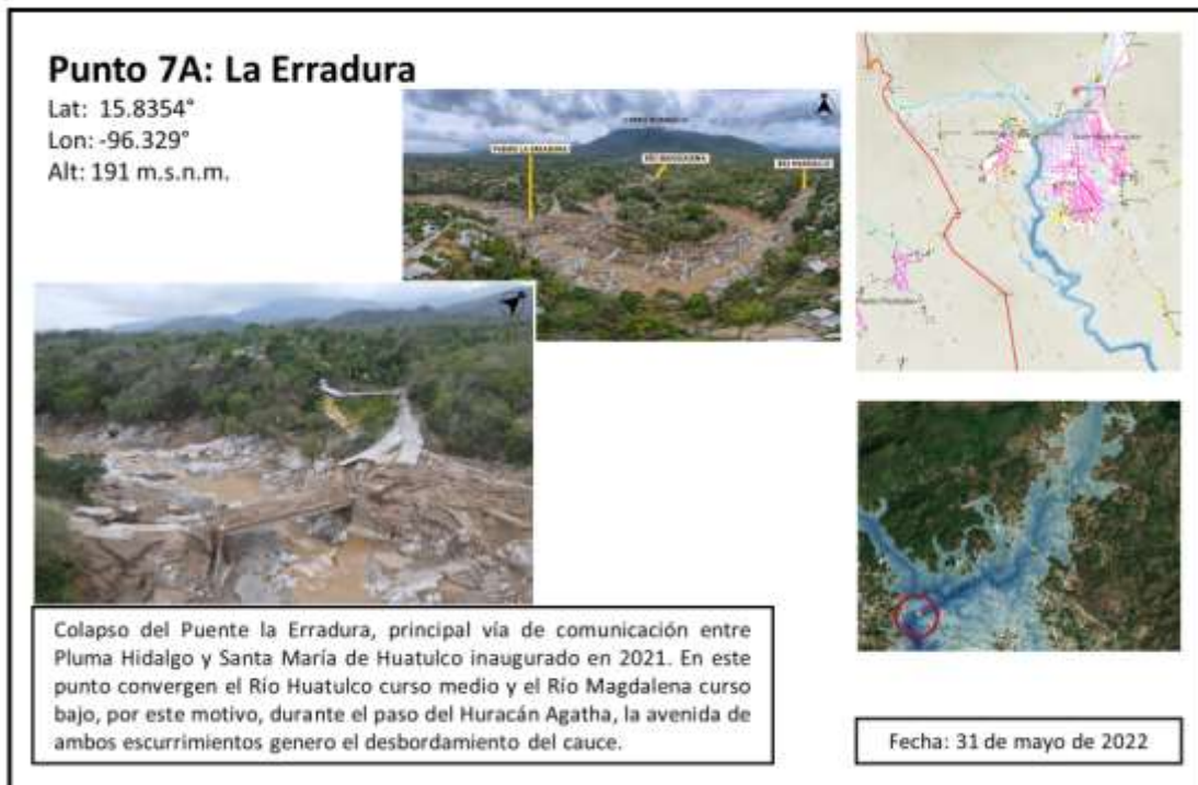
Figura 16. Descripción de zonas de afectación durante el Huracán Agatha (2022). Punto 7A: Puente La Erradura
