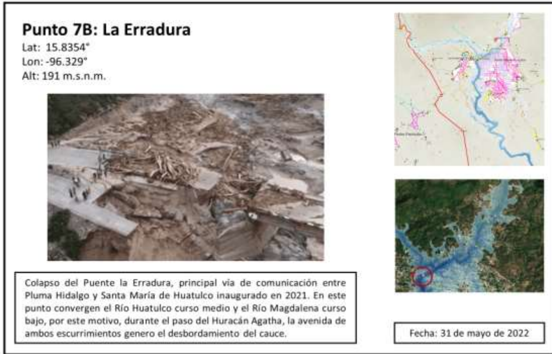
Figura 17. Descripción de zonas de afectación durante el Huracán Agatha (2022). Punto 7B: Puente La Erradura
