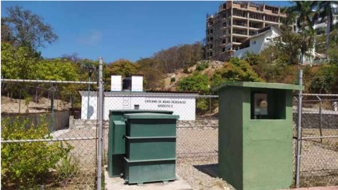
Fotografía 25. Cárcamo de aguas residuales Arroquito III
